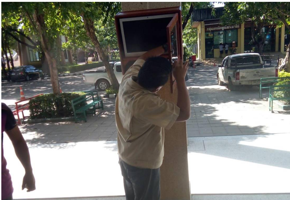
ติดตั้งระบบแสกนบัตรประจำตัวนักเรียน
