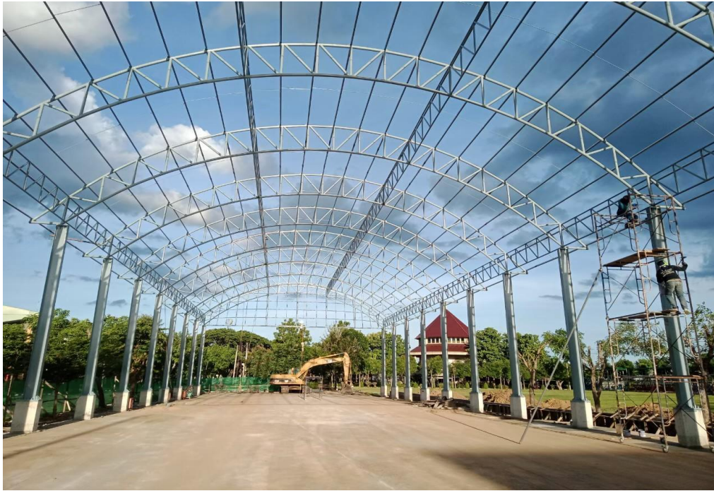
การก่อสร้างโดม เซนต์ปีเตอร์โดม ใหม่ของโรงเรียนมารีย์อนุสรณ์
