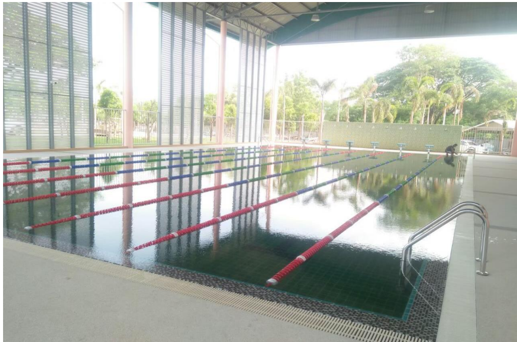
สร้างสระว่ายน้ำ และแล้วเสร็จพร้อมใช้ ในปีการศึกษา 2563
