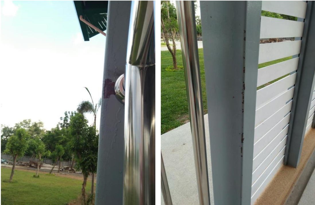
ซ่อมแซมส่วนที่ชำรุดของอาคารสระว่ายน้ำของโรงเรียนมารีย์อนุสรณ์
