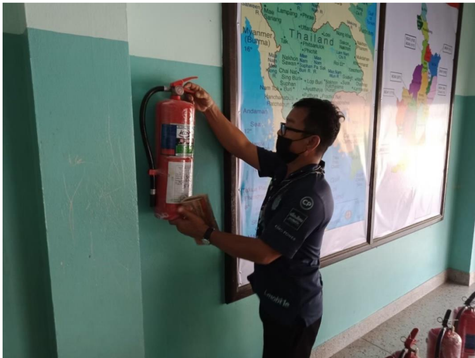
เจ้าหน้าที่ตรวจเช็คถังดับเพลิงหากชำรุดหรือหมดอายุต้องปรับเปลี่ยนให้พร้อมใช้
