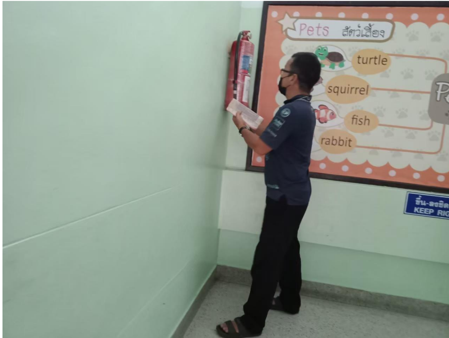
ติดตั้งถังน้ำยาดับดับเพลิงใหม่พร้อมบันทึกอายุการใช้งาน
