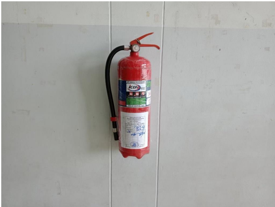
ถังน้ำยาดับเพลิงถูกติดตั้งในจุดเสี่ยงและมองเห็นพร้อมใช้งานทุกจุด
