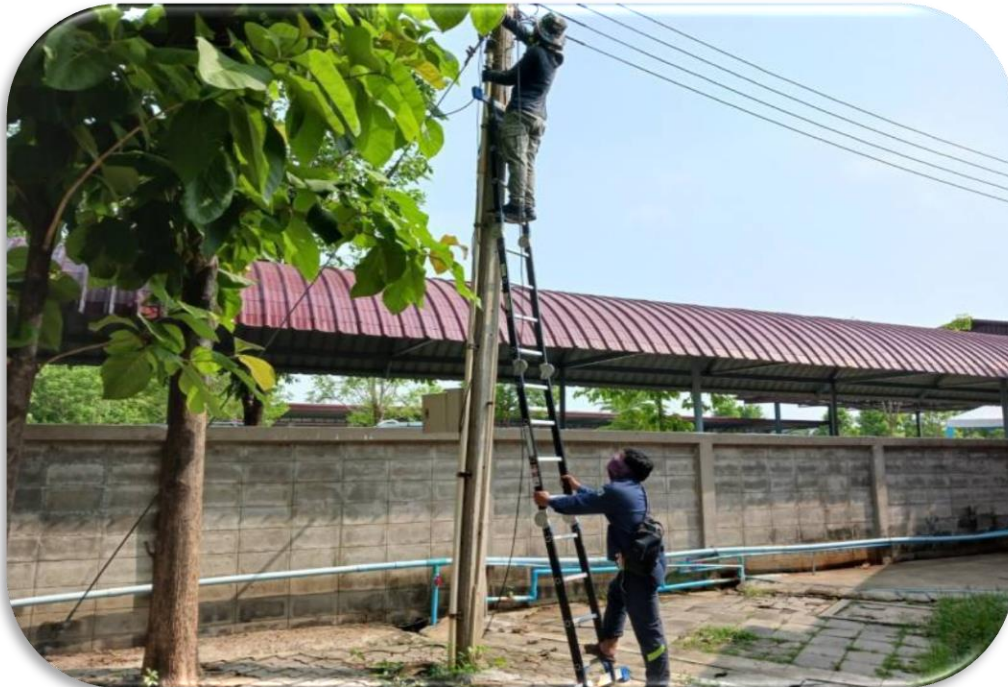
ติดตั้งระบบวงจรปิดครอบคลุมทุกพื้นที่ในบริเวณโรงเรียน
